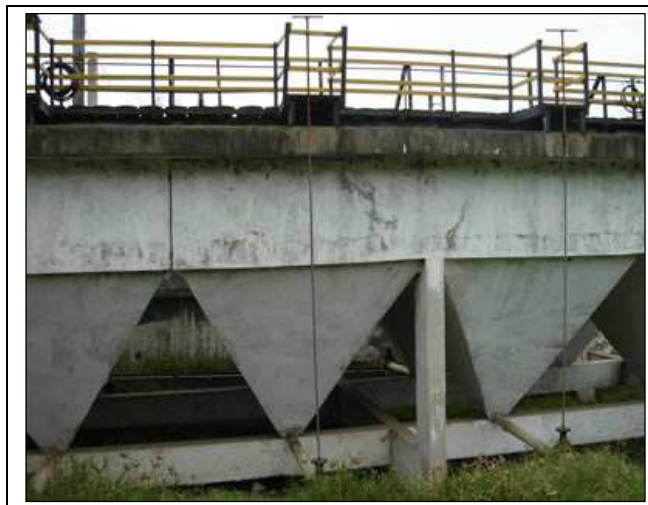
Figura 10 – Ilustração dos Decantadores Primários do Aimoré Couros Ltda.
