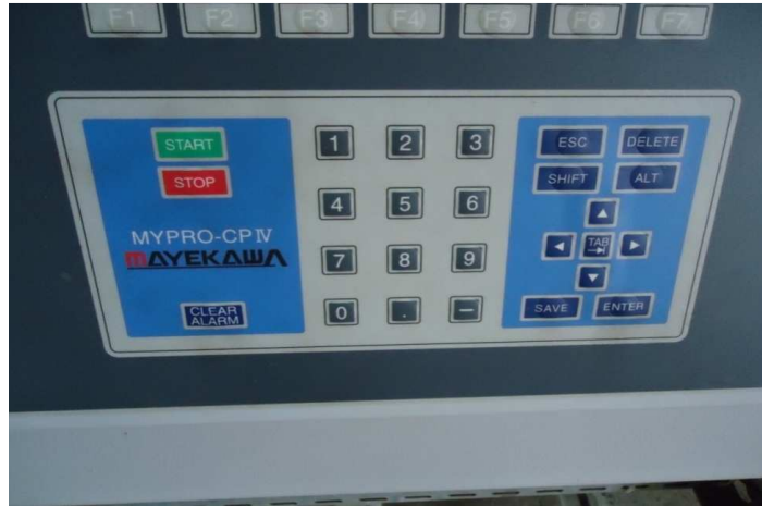
Figura 14 - Painel de comando de compressor de ar
