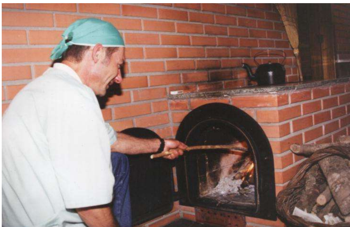
FIGURA 11 - Caldeira para o aquecimento da estufa. Fonte: Entre Ervas Ltda.
