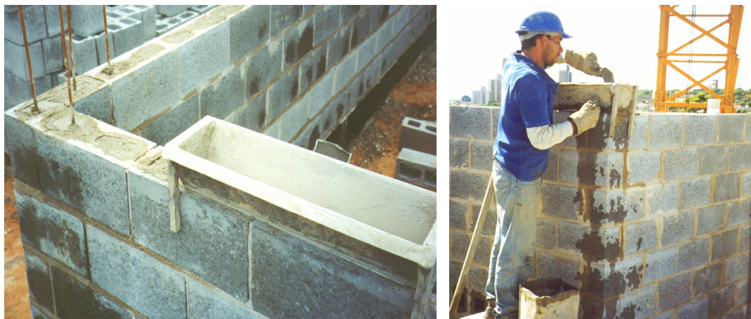
Figura 20 – Fôrma utilizada para facilitar a colocação do graute no interior dos vazados dos blocos.
