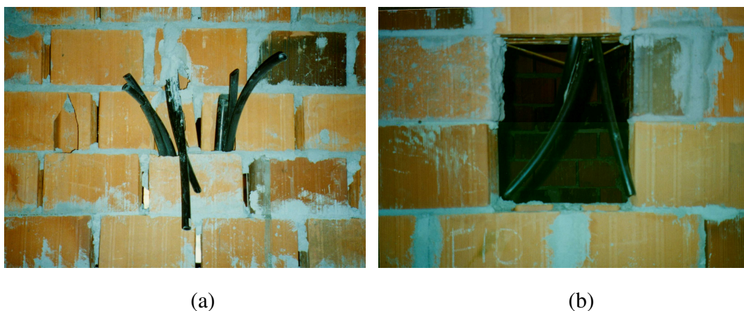
Figura 26 – Local para o quadro de disjuntores, não previsto durante a fase de execução da alvenaria (a) e previsto (b).
