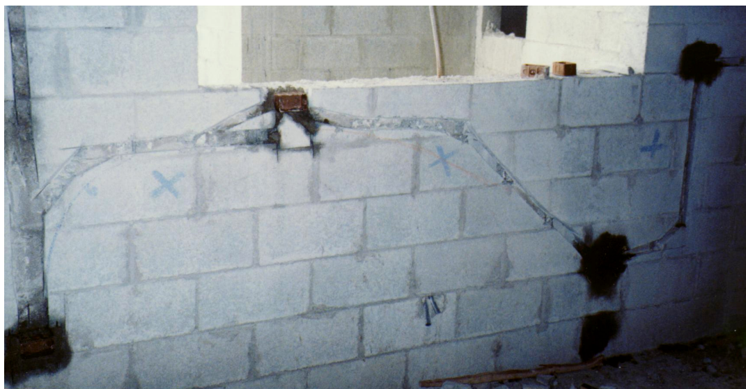
Figura 25 – Passagem de tubulação elétrica sem adequada integração de projetos.
