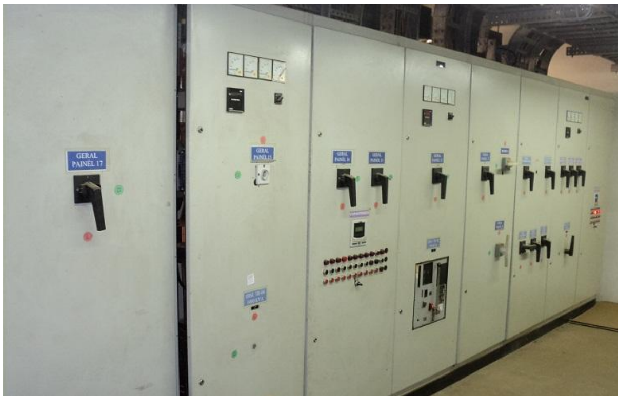
Figura 63 – Sala de comando da subestação
