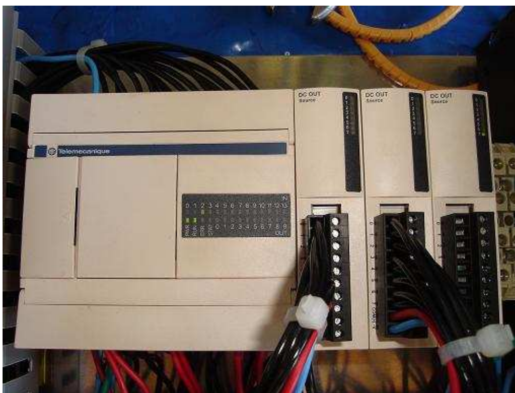
Figura 22: CLP - Controlador Lógico Programável utilizado na separação
