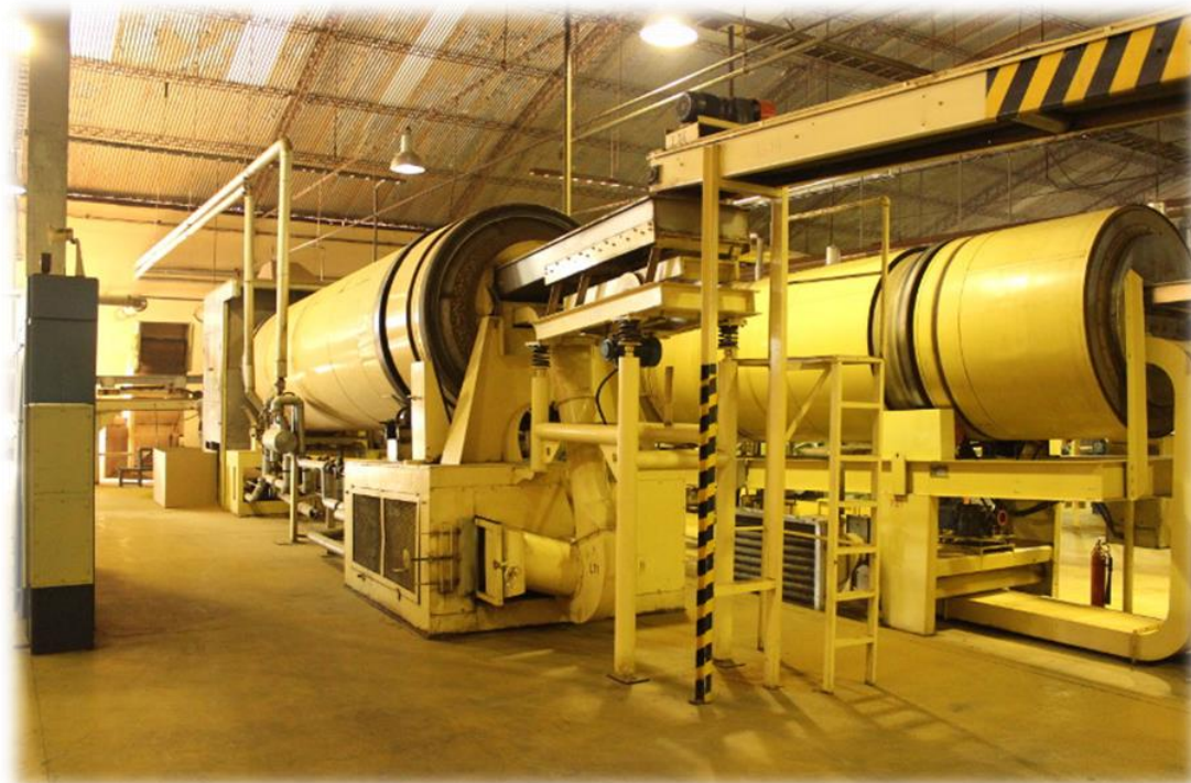
Figura 09 – Foto 2 das máquinas da Usina de tabaco da CTJ
