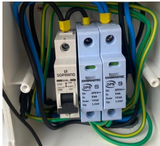
Figura 8 – Disjuntor e DPS.
