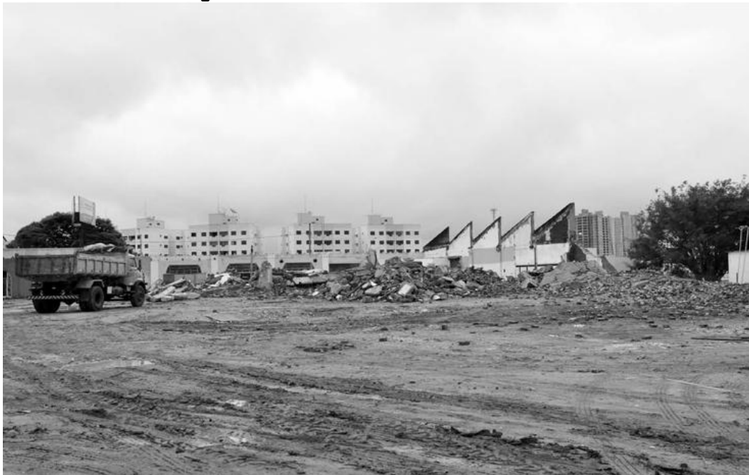
Figura 11 - Escombros da Fábrica da Embaré
