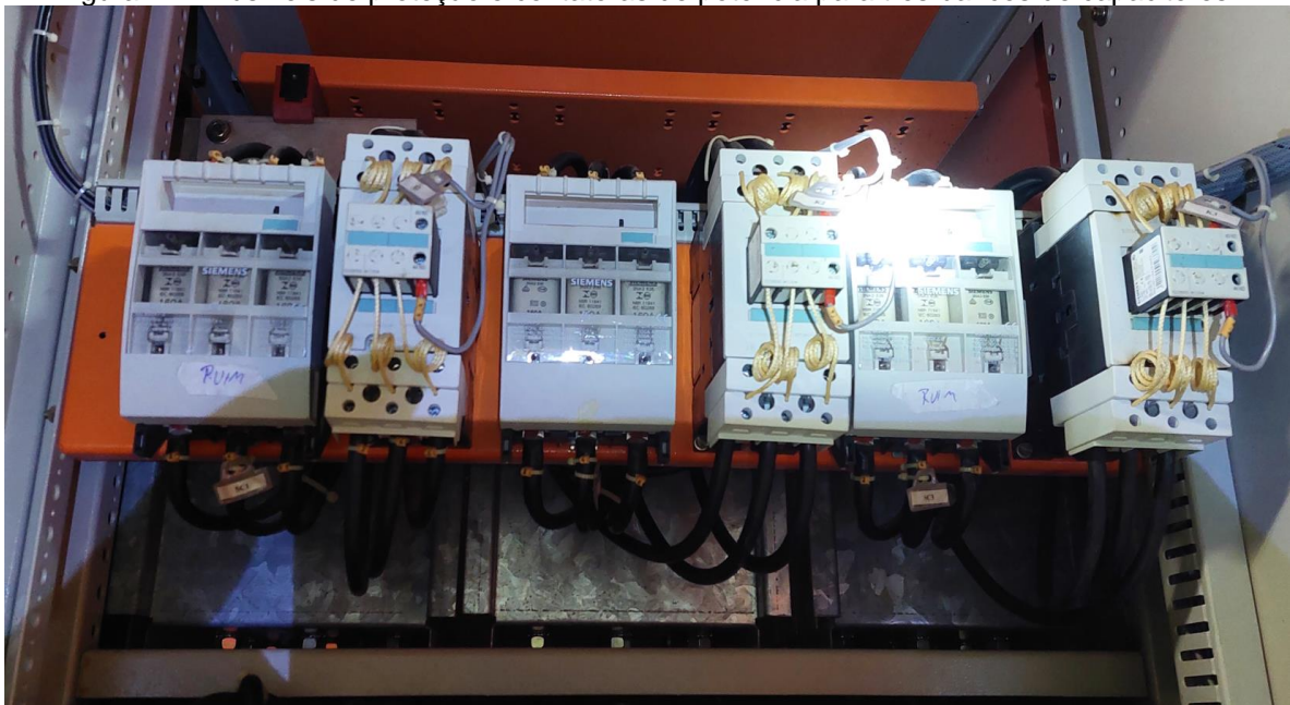
Figura 11 – Fusíveis de proteção e contadoras de potência para três bancos de capacitores.
