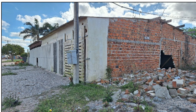
Figura 71. Construções afetadas pela enchente de 2024, com fechamento improvisado
