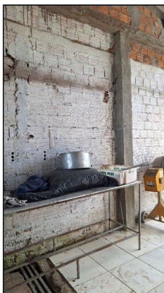
Figura 67. Marca da água da enchente na parede da peixaria
