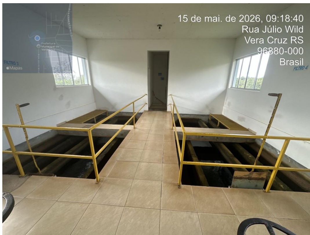
Figura 10 - Detalhe interno da casa de filtros da Estação de Tratamento de Água de Vera Cruz/RS, evidenciando as baterias de filtração rápida.
