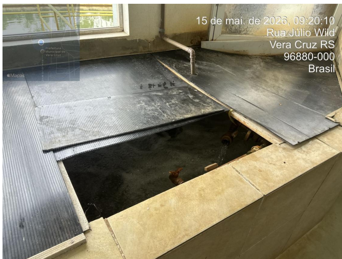
Figura 14 - Estrutura de chegada de água bruta e câmara de mistura rápida da ETA Central, ponto designado para a reincorporação do efluente clarificado proveniente dos leitos de drenagem.
