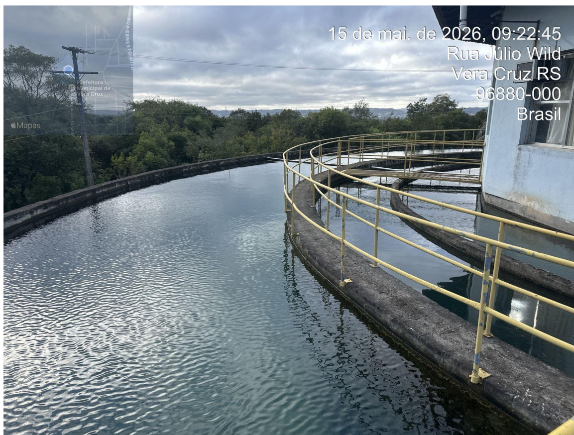
Figura 1 - Unidades de floculação e decantação da ETA Central de Vera Cruz/RS, estruturas onde ocorre a principal geração contínua do lodo a ser desaguado.
