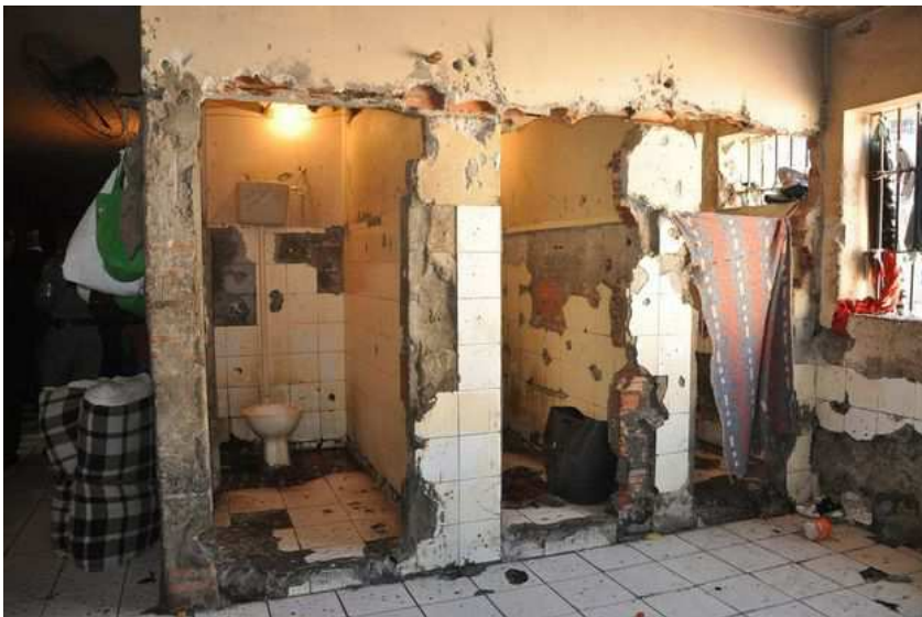
Foto de banheiros deteriorados no Presídio Central de Porto Alegre/RS. Fonte: http://www.jb.com.br/pais/noticias/2012/05/08/presidio-de-porto-alegre-tem-mais-do-dobro-da-lotacao-prevista/ .
